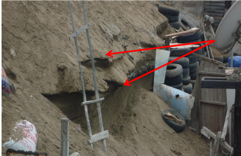
Foto 10. Niveles de concentraciones y patinas de sales.
