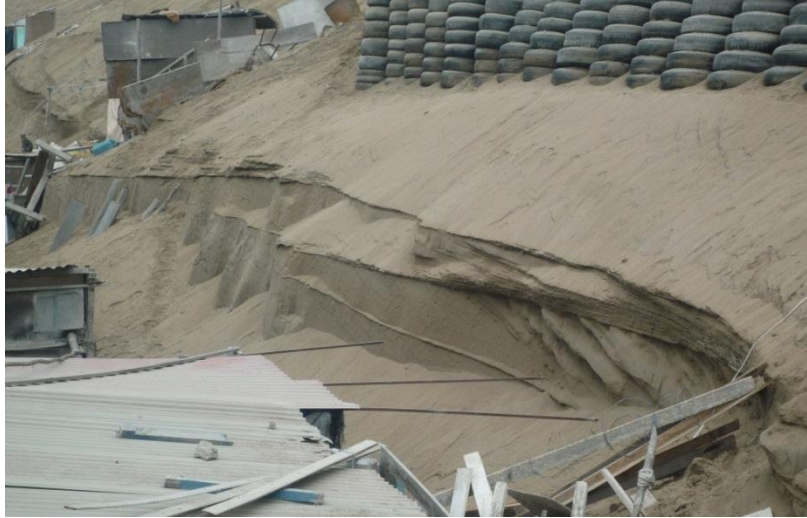
Foto 7. Talud de corte en arenas eólicas (SP), obsérvese la estratificación cruzada, producto de los diversos ángulos de deposición y lo inestable del talud.
