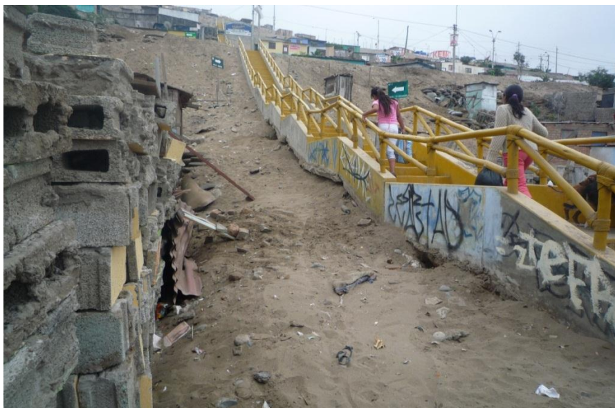
Foto 15. Base de la escalera, está quedando al aire por movilización de las arenas.
