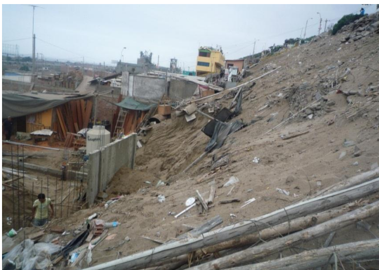
Foto 13. Sector susceptible a derrumbes. Arena movilizándose hacia el muro de una vivienda en plena construcción.
