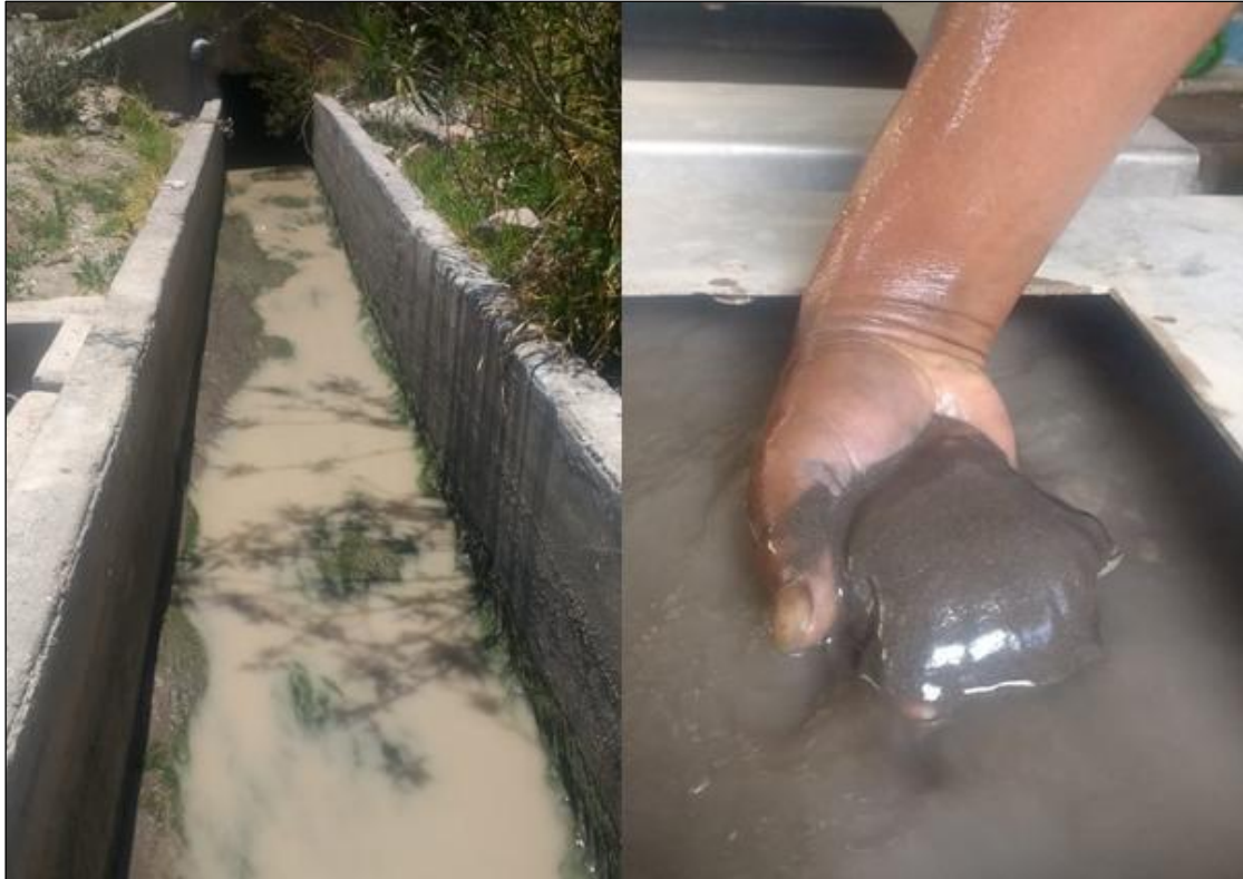
Figura 27: Colmatación de los canales de la Planta Hidroeléctrica Lluta y Llucta reportado en el mes de octubre del año 2020.
