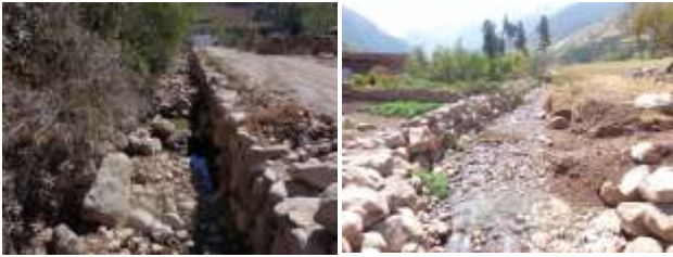
Fotos 8 y 9.- Canal ensanchado a aproximadamente 2m (izquierda), canalización provisional en el poblado de San Isidro, ubicado en la parte alta de la quebrada (derecha)
