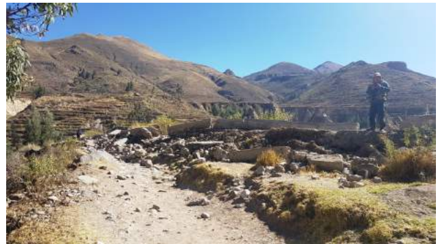
Foto 8. Canal destruido por efecto de la amplificación de ondas sísmicas, el suelo y el tipo de construcción.
