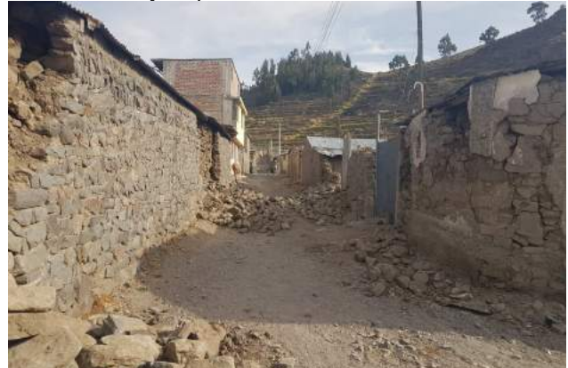
Foto 10. Muros colapsados por efecto de la amplificación de ondas sísmicas, el suelo y el tipo de construcción, nótese la vivienda de material noble que no sufrió mayor daño.
