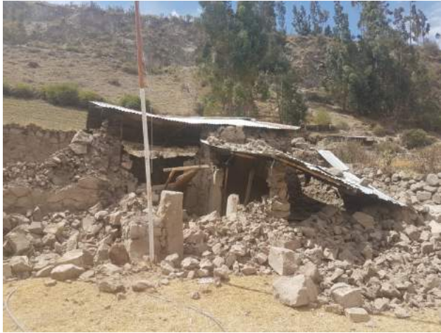
Foto 6. Vivienda colapsada por efecto de la amplificación de ondas sísmicas, el suelo y el tipo de construcción.
