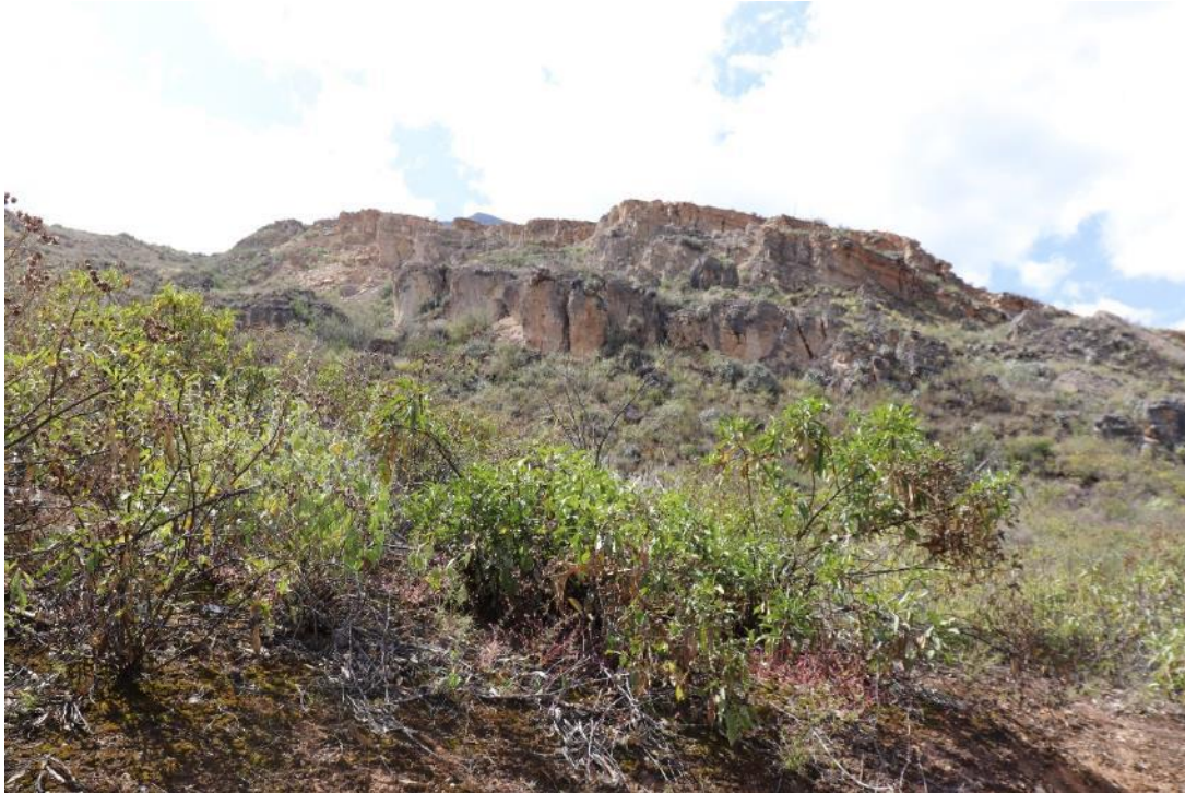
Fotografía 5. Vista panorámica de escarpe principal de antiguo deslizamiento, tomado con dirección sur. Se observa salto vertical que varía entre 15 a 20m.
