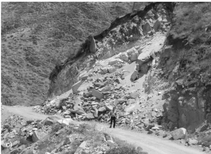
Figura 18: Deslizamiento planar (a), caída de rocas (b) y derrumbe (c), detonados por el sismo que afectaron tramos de las carreteras de penetración a la sierra.
