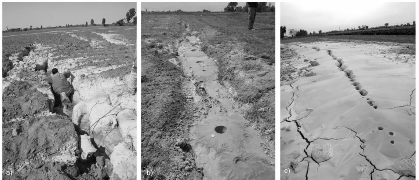
Figura 12: a) Sector Toscana/José Olaya. Grietas de hasta 1 m de ancho y profundidad y fracturas en echelón con emanaciones de agua y lodo; b) Volcanes de arena a lo largo de una grieta longitudinal, sector Manrique; c) Alineamiento de estructuras, sector Canta Gallo.
