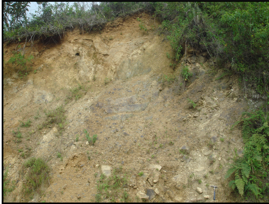
Fotografía N° 7.- Volcánicos Porculla bastante alteradas en el que se aprecia una fuerte alteración cerca a una aparente estructura.
