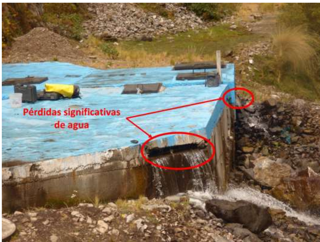
Fotografía 9.1. Desperfectos en la captación del manantial Ancall conduciendo a pérdidas significativas de agua
