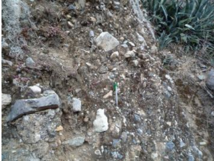
Foto 6. Vista en detalle del material que conforma el deslizamiento.
