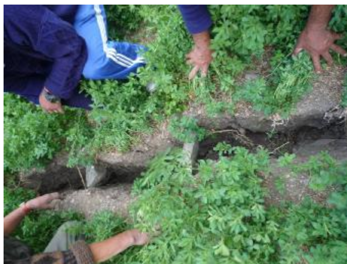
Foto 5. Agrietamiento de 25 cm de abertura.
