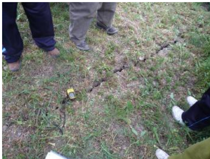
Foto 4. Vista donde se observa una de las rajaduras (abertura de 5 cm)
