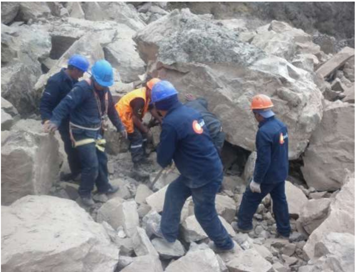
Fotos 7 y 8. Vista de los trabajos de remoción de escombros o rocas originado por el derrumbe, donde se puede distinguir el tamaño de los bloques caídos (Fotos proporcionadas por la municipalidad de Tuti).
