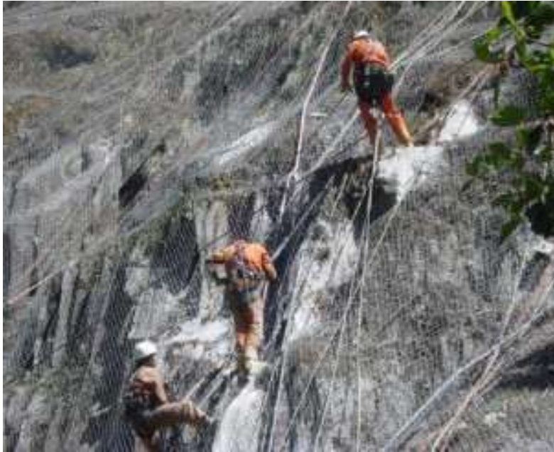
Foto 10. Ejemplo de trabajos de colocación de enmallado para protección de caída de rocas y derrumbes en taludes rocosos con fuerte pendiente.
