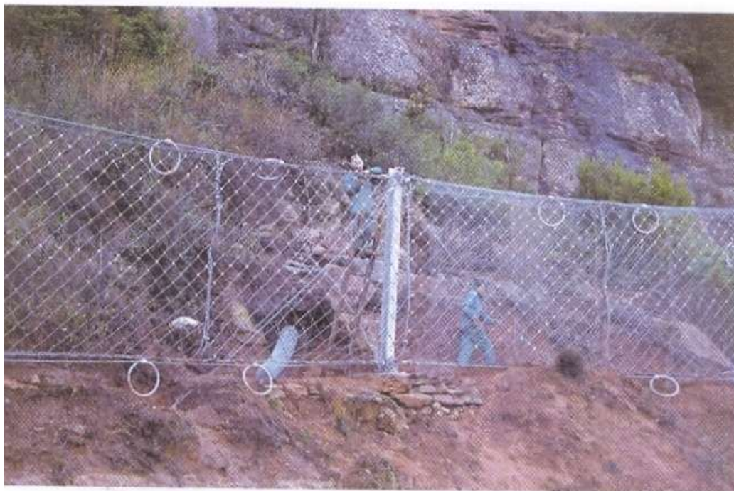
Foto 9. Ejemplo de barrera estática para protección de caída de rocas.
