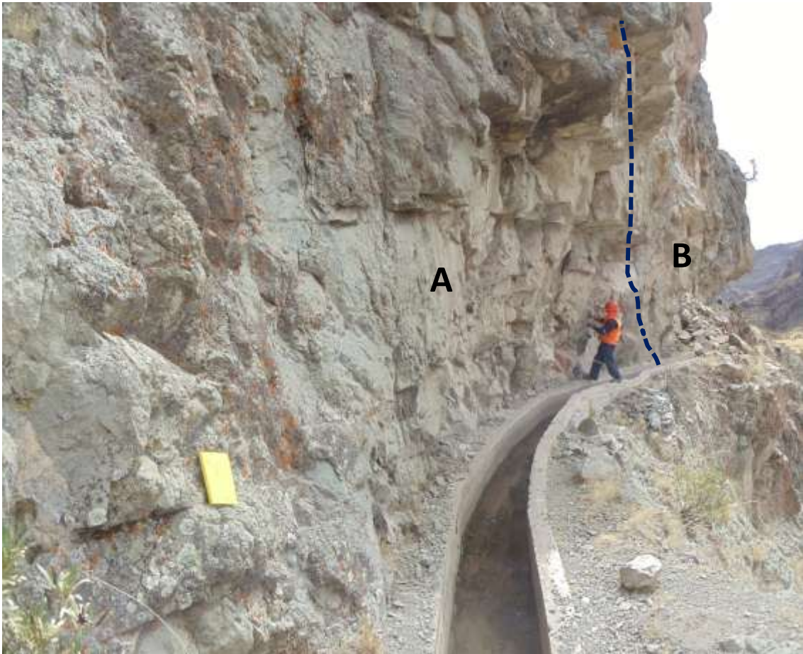
Foto 6. Diferencia de litología en el corte del talud del canal que muestra una zona medianamente estable (A) y una zona inestable (B), donde se produjo el derrumbe del 03/10/2011. Se distingue también la estratificación subhorizontal contratalud en los volcanoclásticos (aglomerados) gris verdosos. La sección del canal de agua que conduce 70-80 L/s es de 50 x 50 cm.
