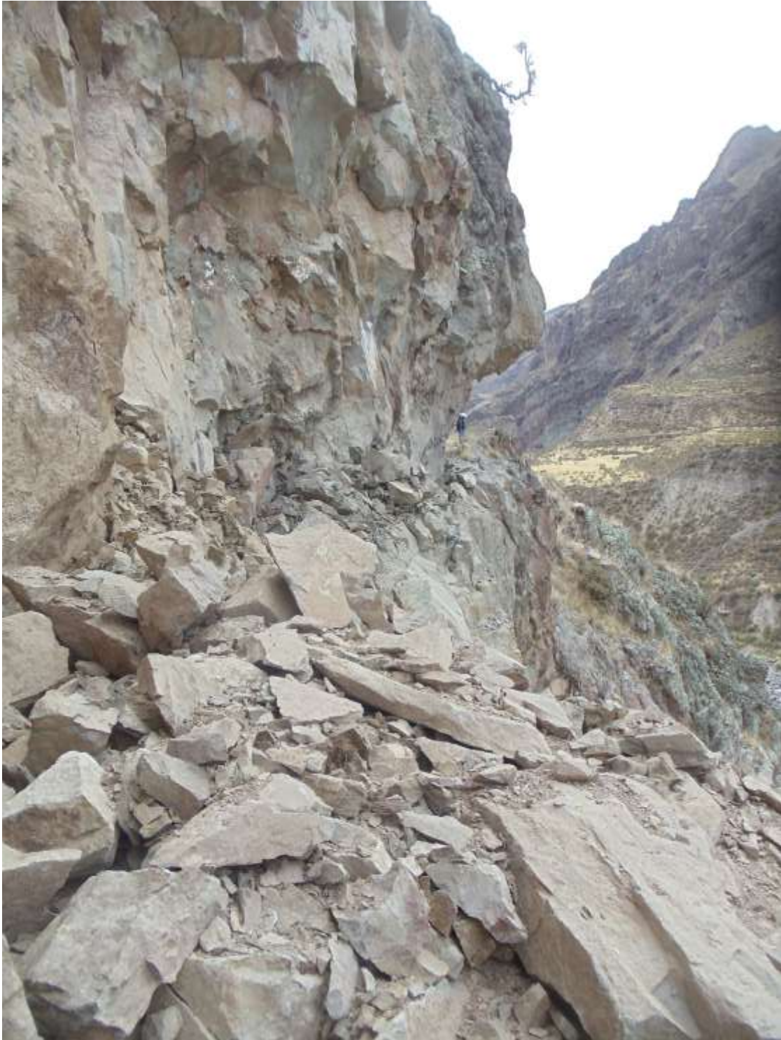
Foto 5. Zona Crítica en el tramo del canal, que han cubierto por completo la sección del canal (tramo de 50 m). Nótese el tamaño de los bloques inferiores a 0,50 m y la pared superior a este con zonas inestables.
