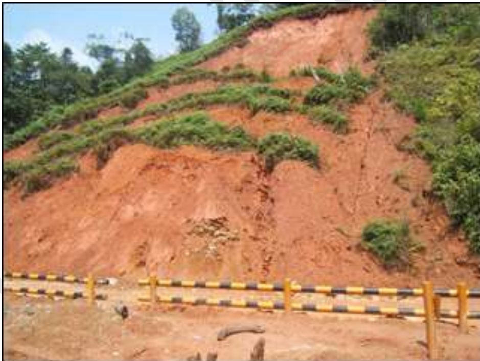
Fotografía 2.2. Montenegro: Deslizamiento traslacional activo en talud superior de carretera.
