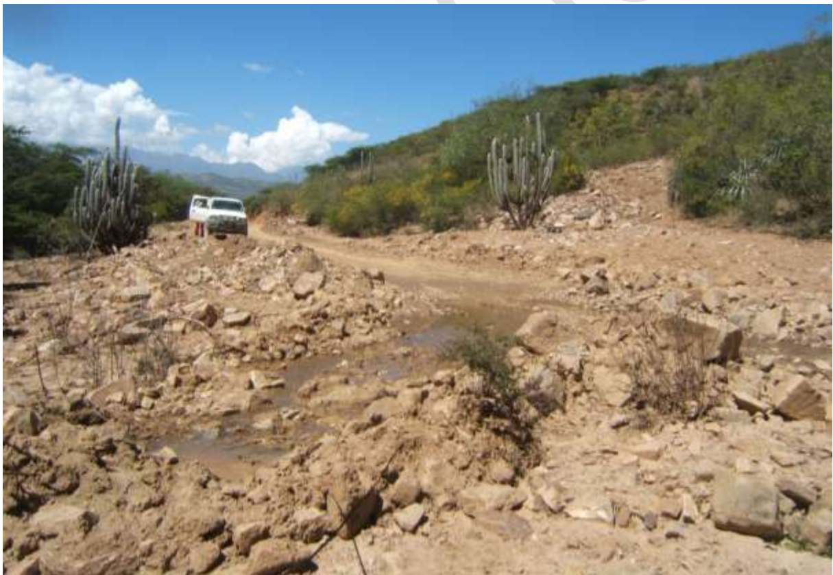
Fotografía 3.2. Depósito de huaico que afectó un sector de la carretera Tabacal-Cachachi. Zona de huaycos periódicos por presencia de erosión de laderas en la cabecera de quebrada.
