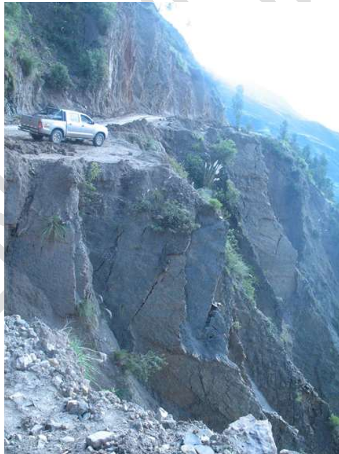
Fotografía 4.6. Talud susceptible a derrumbes, cuya pendiente es muy escarpada y presenta agrietamientos. Sector Potrerillo (Quebrada Chivo).
