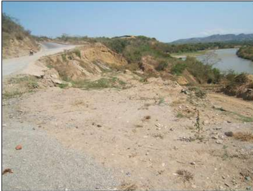
Fotografía 2.11. Plataforma de la carretera Fernando Belaunde Terry, sector San Luis afectado por deslizamiento.
