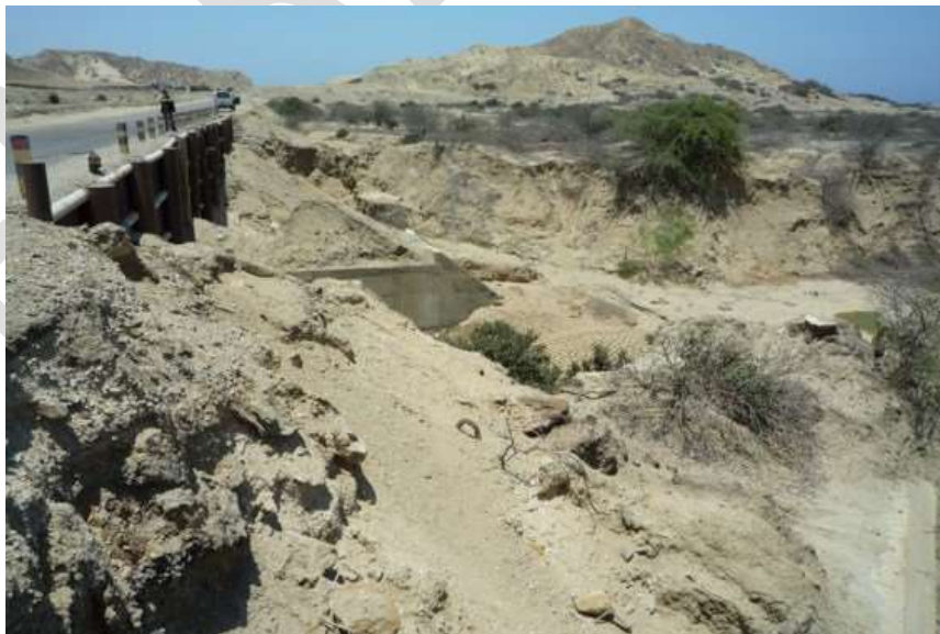
Fotografía 7.11. Carretera Talara-Negritos, cortada en varios sectores por torrenteras que se activan excepcionalmente.
