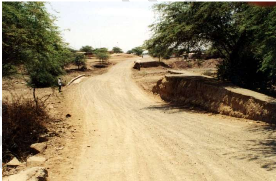
Fotografía 7.12. Carretera Sullana – Lancones afectada por flujos de lodo y huaycos en varios tramos, donde se ha perdido la plataforma asfaltada y las alcantarillas. Se han tenido que realizar variantes.
