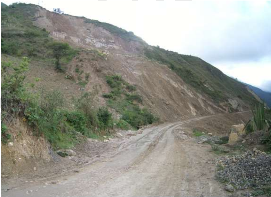
Fotografía 3.8. Deslizamientos traslacionales en el Sector de El Pollo, cerca de Paccha, afectan periódicamente tramo de carretera de acceso a Paccha y Chadín.
