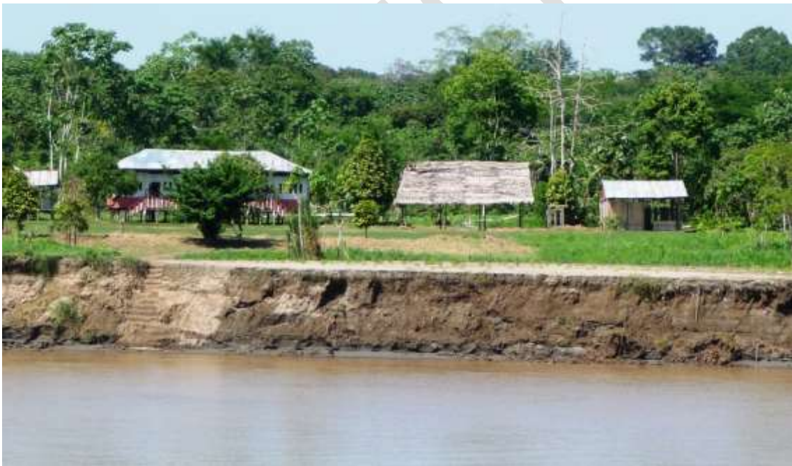
Fotografía 6.7. Las Palmas, susceptible a inundaciones y erosiones fluviales.
