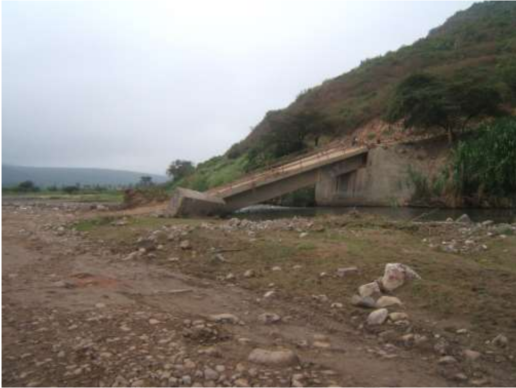
Fotografía 5.2. Inundación, flujo de detritos, erosión fluvial en Las Delicias-Santa Rita.
