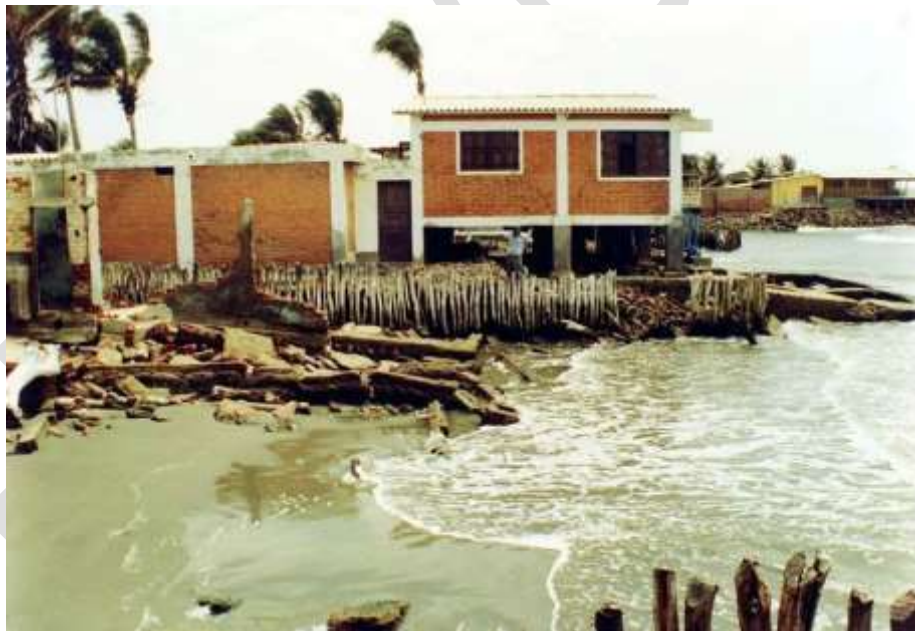
Fotografía 7.7. Procesos de erosión marina que afectan viviendas en La Esmeralda del distrito de Colán, provincia de Paita.
