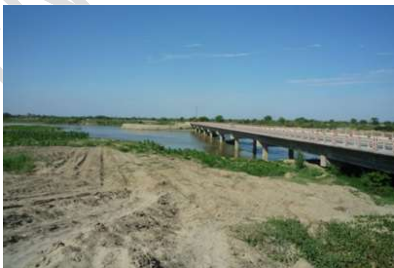
Fotografía 7.1. Puente Independencia, vista aguas arriba. En su margen izquierda se han colocado espigones y gaviones para controlar la erosión.
