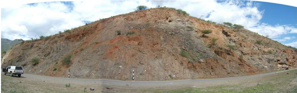
Fotografía 3.12. Amplio sector entre las quebradas Huabal y Tasajeras donde los taludes de corte con rocas muy alteradas muestran procesos de erosión de laderas, derrumbes, caída de rocas y deslizamientos, huaycos canalizados en las quebradas.
