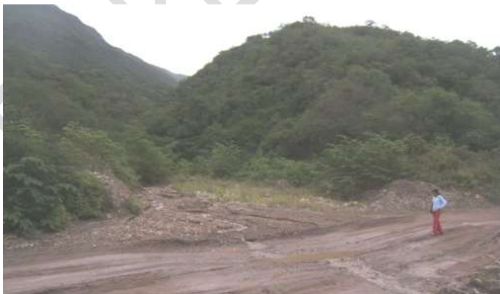
Fotografía 3.14. Sector cercano a Boca Chirinos afectada por flujo de detritos periódico que afecta un tramo de 150 m de la carretera entre Jaén y San Ignacio.
