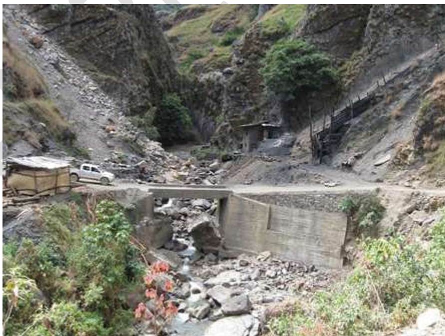
Fotografía 4.3. Derrumbe entre la quebrada Lirios y Ciénegos, distrito Huaranchal, provincia Otuzco, afecta carretera de acceso a Huaranchal.
