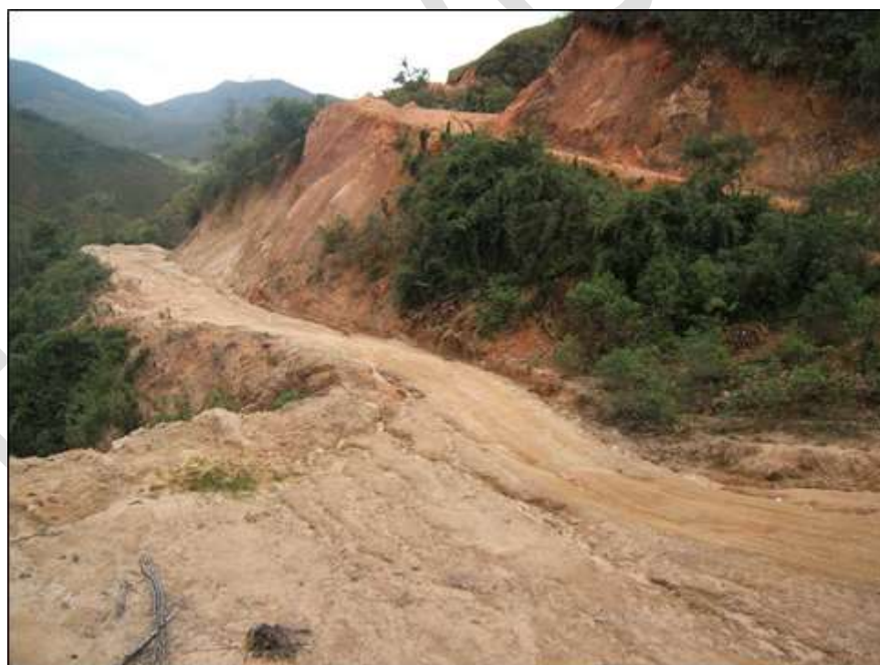
Fotografía 2.9. Derrumbes, erosión en surco y pequeños deslizamientos afectan a la carretera de acceso al valle turístico de Huaylla Belén.
