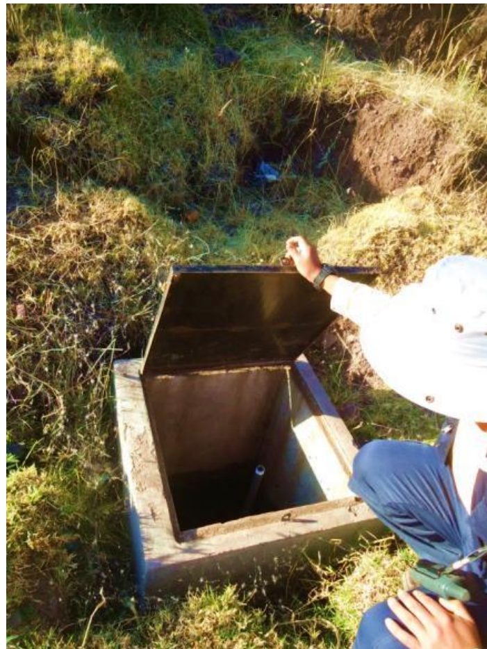
Foto 2. Buzón de sistema de regadío tecnificado inoperante.
