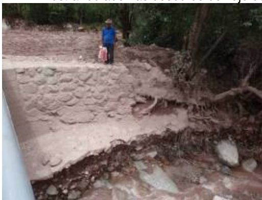
Foto 33: Puente con margen erosionada-
