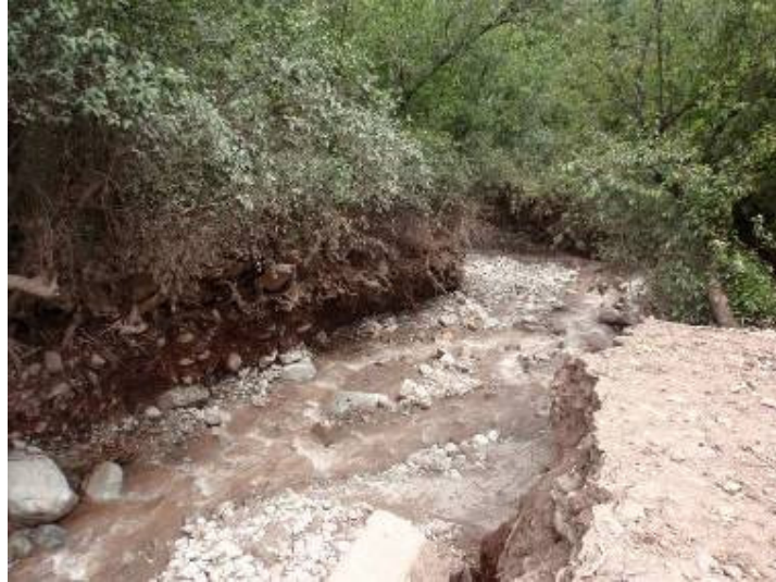
Foto 31: Márgenes con material aluvial antiguo del río Chicón, erosionadas por el aluvión del 17 de octubre del 2010.
