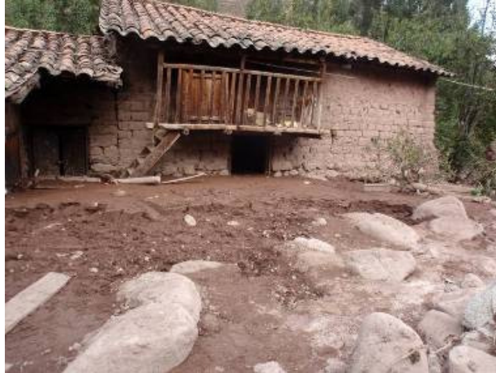
Foto 38: Vivienda destruida por el reciente aluvión.
