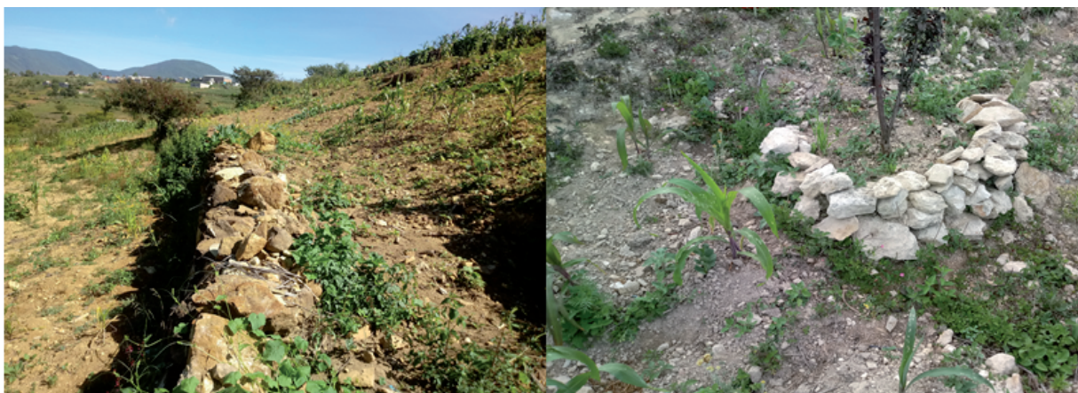
Figura 1. Muros de retención en Yareni (izquierda) y terrazas individuales en Abejones (derecha).
