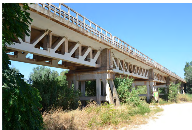
Figura 19. Tramos de la margen izquierda, sobre la zona inundable del Guadalquivir. Se observa el refuerzo de cordones y diagonales atornillado al tablero. Foto del autor.
