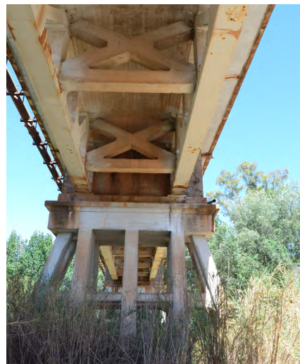
Figura 18. Arriostramientos transversales en cruz de San Andrés, incorporados con posterioridad a la ejecución de las vigas principales a instancias del ingeniero López Molero. Foto del autor.
