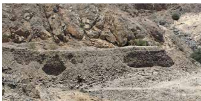
Figura 69 Detalle de muro colapsado relleno de cascajo y gravilla
