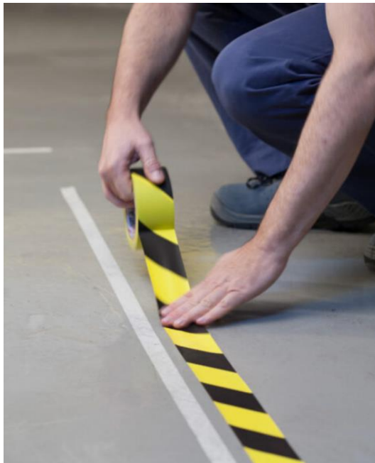
Figura 12: Señalización en pasadizos
