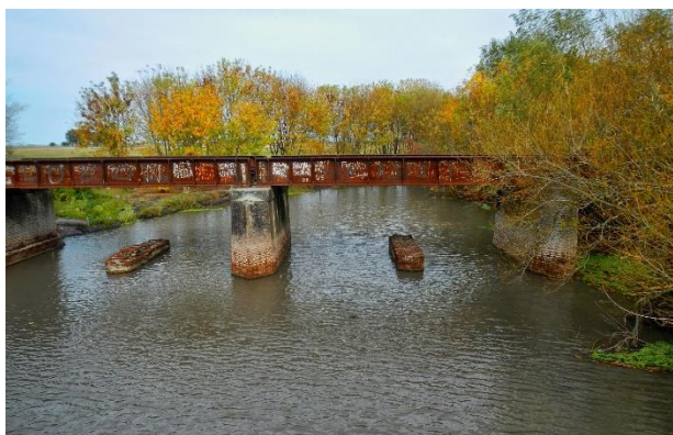
Fig. 9. Ignacio Correas, puente ferroviario Arroyo El Pecado Fuente: Lugares – Ignacio Correas – Grupo La Loma
