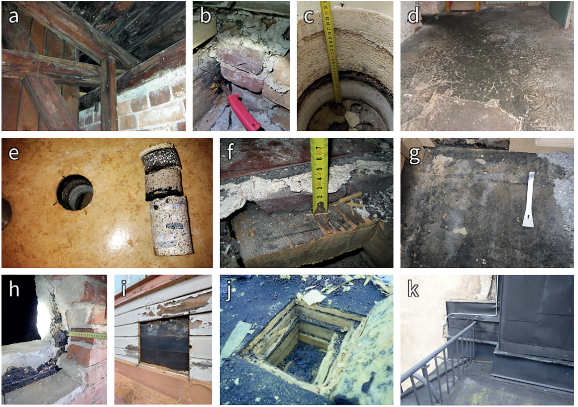
PAH-yhdisteitä sisältäviä rakennusmateriaaleja: a) kivihiilitervalla käsitelyjä ullakon puupalkkeja, b) tervattu palkin pää puuvälipohjassa, c) alapohjan pikisively, d) valuasfaltti kellarin lattiassa, e) asfaltti ja sively, f) useita kerroksia PAH-yhdisteitä ja asbestia sisältäviä materiaaleja, g) rintamamiestalon väli-pohjan pikisively, h) pikisively kellarin seinässä tiilen takana, i) tervapahvi julkisivun laudoituksen takana, j) eri-ikäisiä vesikaton kermejä ja sivelyjä ja k) vesikaton kermi ja pikimaali [1].
