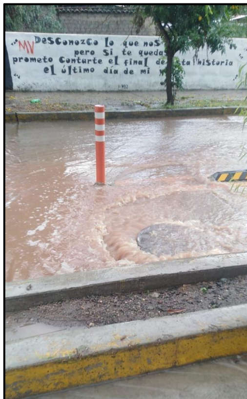
Fotografía 2. Colapso de buzones producto de la unión de caudales de drenaje y aguas servidas.
