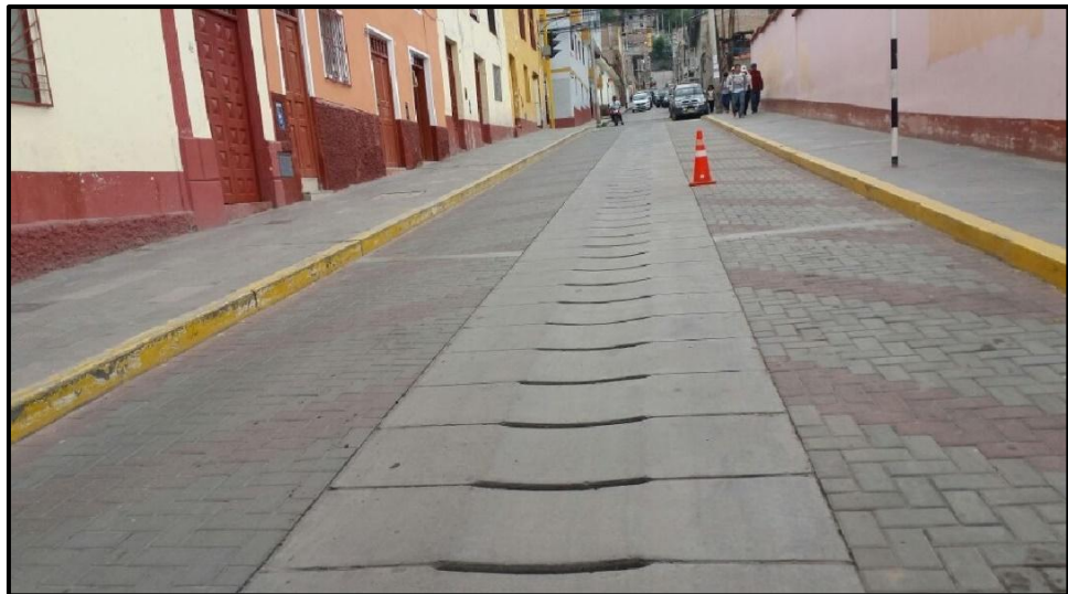
Figura 3. Sistema de drenaje pluvial culminado.
