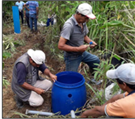
Figura 5. Instalación de tanque de carga
