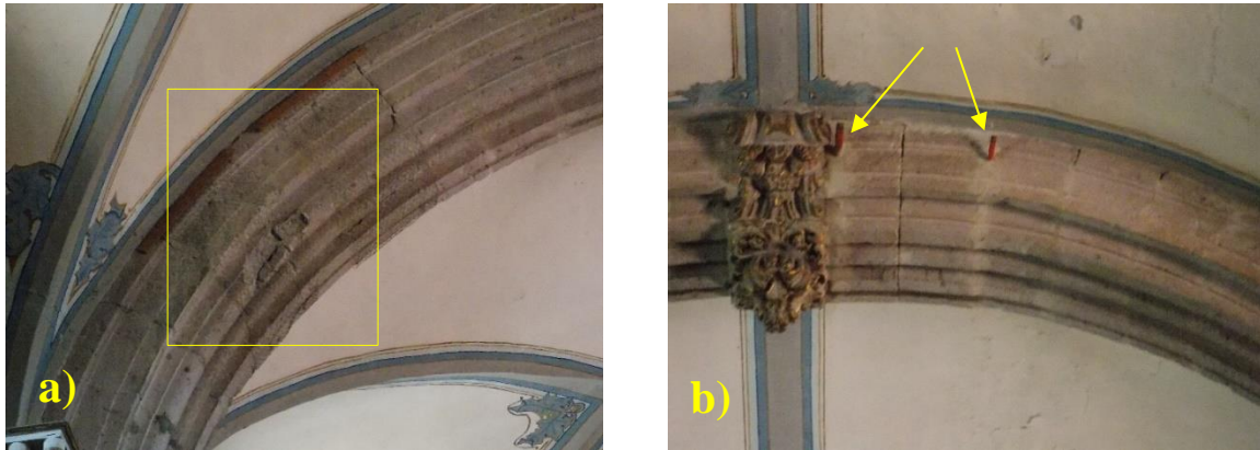
Figure 11: a) Daños en arco fajón and b) mortar injection nozzles
