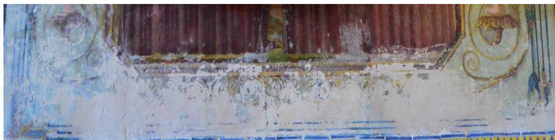
Figura 9. Pormenor da zona inferior do painel com boca de cena sob o púlpito (parede Sul), onde se observam as lacunas causadas pela presença de sais.
