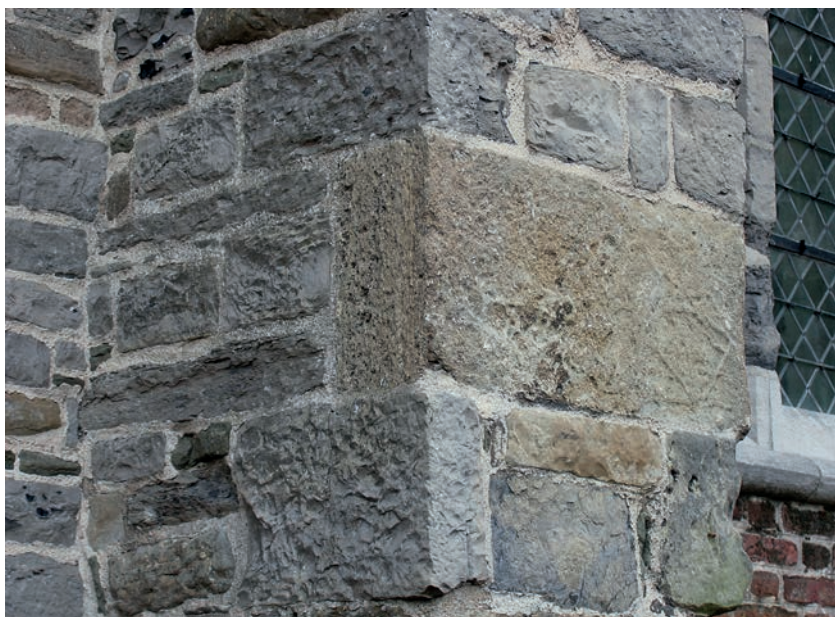
FIG. 32 Aardenburg, Sint-Bavokerk. Blok Ledesteen in een steunbeer van de westgevel. Aardenburg, St Bavo's Church. Block of Ledestone in a buttress of the western façade.
