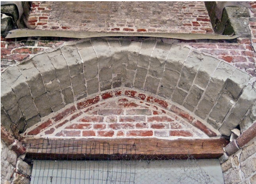
FIG. 10 Boog in verweerde (verkrummelend) lichtgroene kalkzandsteen (Baumberger kalkzandsteen). Lokaal zijn kleine donkergrijze verkiezelde zones herkenbaar. Arch built in weathered (crumbly) light green (Baumberger) sandy limestone. Occasional small, dark-grey silicified patches can be identified.
