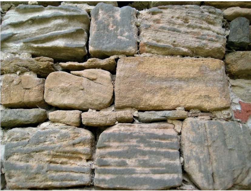
FIG. 13A Zandsteen van Le Quesnoy in de westtoren van de OLV-kerk. Differentieel verweerde, licht rozige tot asgrijze middelmatig gekorrelde tot grofkorrelige kwarsrijke zandsteen met vervuild oppervlak. We herkennen twee lagen zandsteen van Le Quesnoy (boven en onderaan) en een laag oranje-gele oölitische kalksteen van Marquise.
