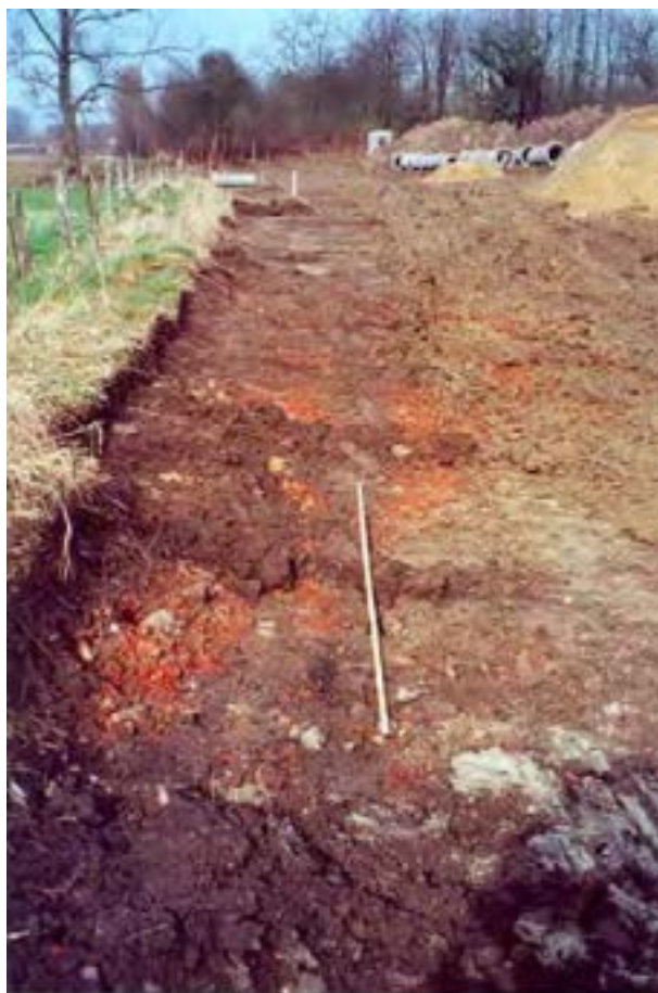
Foto 4. Puinzones in de aanlegstrook van de Aquafin-pijpleiding langsheen P2. (Foto H. Delvaux)
