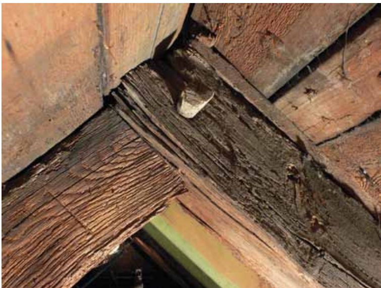
FIG. 17 Halfhoutse verbinding van de koppen van de sporen (THOC, mei 2007). Half-lap joint of the top of the rafters (THOC, May 2007). Assemblage à mi-bois des têtes des chevrons (THOC, mai 2007).
