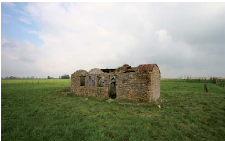
FOTO 30: Bunker Groigne in Oudekapelle (foto K. Vandevorst) Bunker Groigne in Oudekapelle vóór consolidatie door het VIOE. De bunker Groigne is een beschermd monument met Arabische inscripties boven de Moorse toegang.
