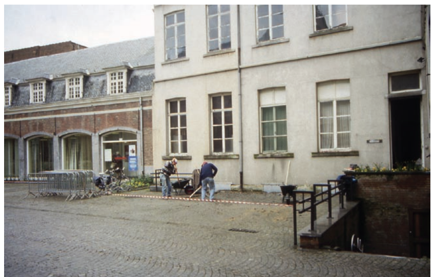
FIG. 2 Zicht op de oostvleugel van het stadhuis van Aalst. Het roodwitte lint markeert de rand van de opgravingsleuf. View on the east wing of the town hall of Aalst. The red-white ribbon marks the edge of the excavation trench.
