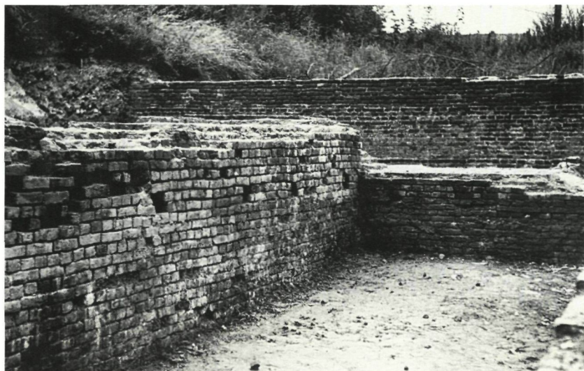
12 Ongevoegde bakstenen en open steiger-gaten in de zuidelijke pandgang (XVIII d ).
