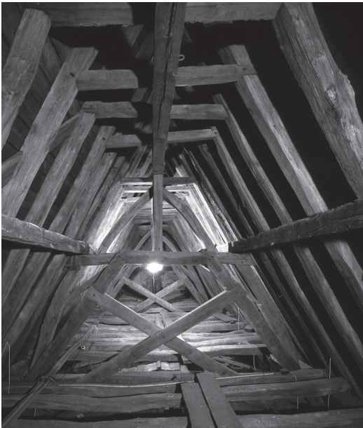
18 In de 18de eeuw werd de kapconstructie boven het westelijke gedeelte van het schip met andreaskruisen versterkt. The trusses of the western part of the roof structure were reinforced with St. Andrew's crosses in the 18th century. (© Oswald Pauwels 2001)
