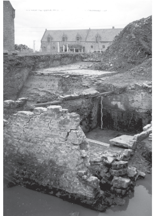
5 Ondergrondse ruimte met aanzet van tongewelf. Subterranean room originally with a barrel vaulting.
