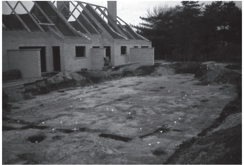
2 Onderzoek in de achtertuin van de toekomstige nieuwbouw. Excavating the backyard of the housing estate.
