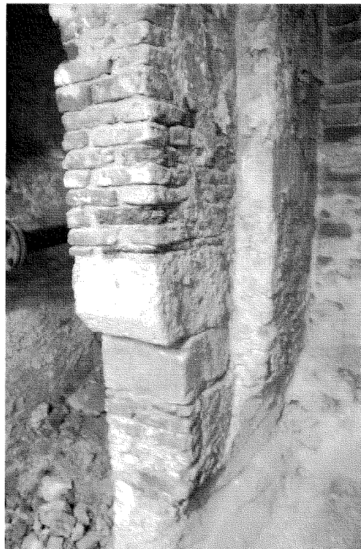
7 Dichtgemetste toegang van kelder B aan de zijde van de Grote Markt. Walled up entrance of cellar B.
