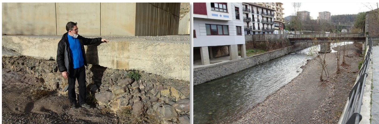
Figura 80. A la izquierda, erosión en el barranco de la Paridera al pie de zona modificada para un puente. A la derecha, presencia de vegetación no natural en el lecho del río Leitzarar, muros y erosión al pie del pilar del puente.
