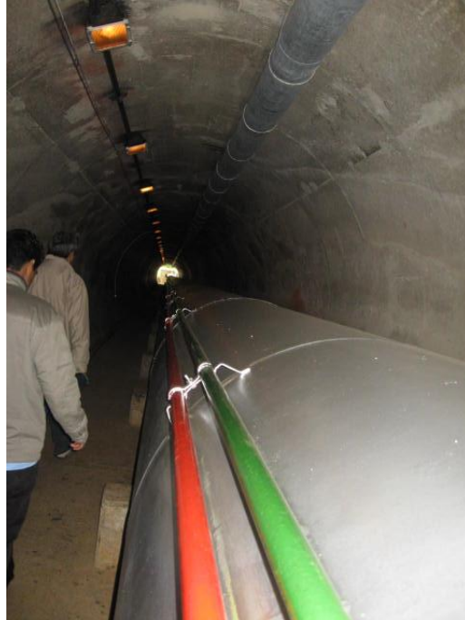
Foto N° 21: tubería de descarga del embalse de Sisga.
