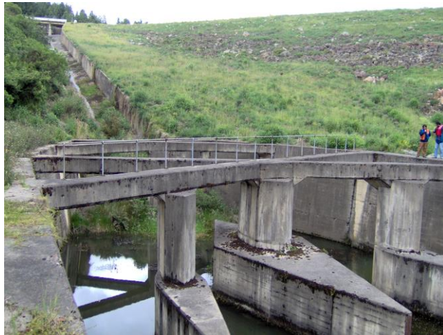
Foto Nº 10: sistema de desenergización de embalse de Neusa.
