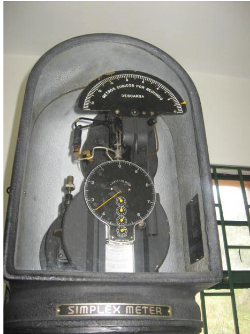
Foto N° 19: Sistema de medición de descargas de embalse de sisga.
