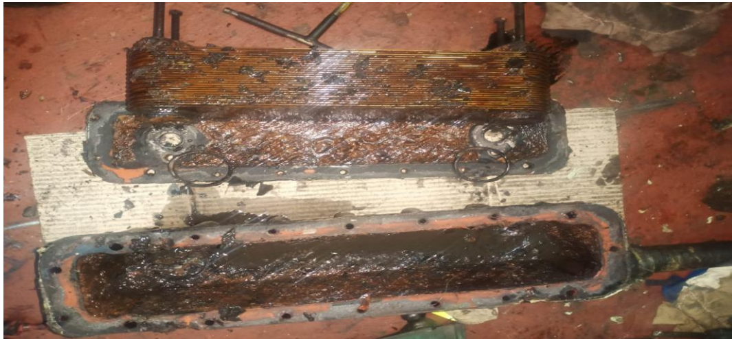
Kondisi lo cooler yang kotor
