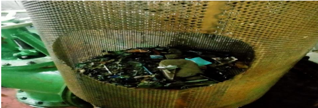
Kondisi filter sea chast yang kotor
