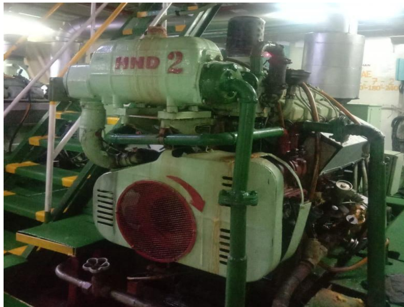
Gambar 2 5 Diesel generator di MV.Tanto Manis
