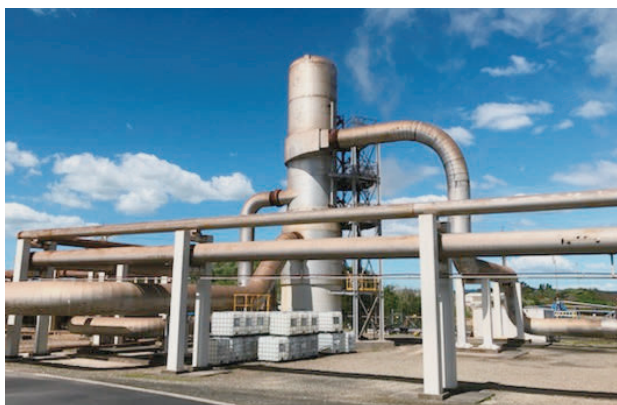
写真6 Kawerau Geothermal Stationの外観および内部の様子
