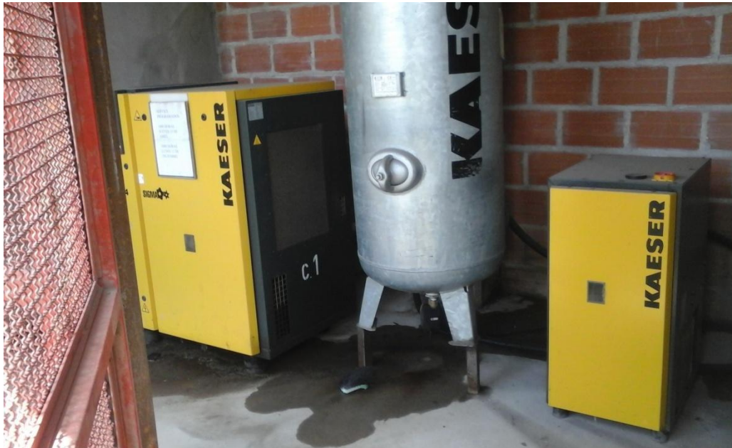
Figura 38. Estación de Aire Comprimido
