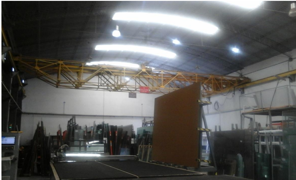
Figura 37. Puente Grúa Reticulado
