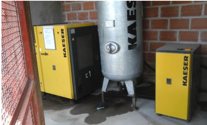
Figura 15. Estación de aire comprimido del Establecimiento
