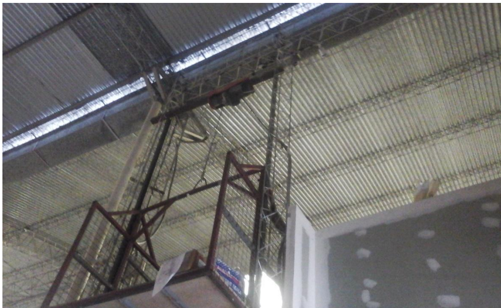
Figura 45. Elevador de Cargas
