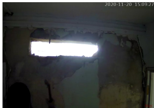
Figura 90. Fotograma de la acción Demolición-apertura de ventana en mi antiguo estudio de Londres, 2020 . Vídeo HD, 3' 05".
