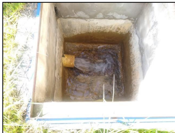
Fotografía 7. Caja de inspección.
