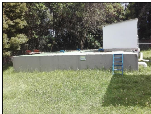
Fotografía 12. Tanque de almacenamiento 2.
