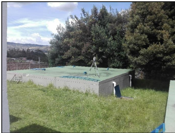
Fotografía 11. Tanque de almacenamiento 1.
