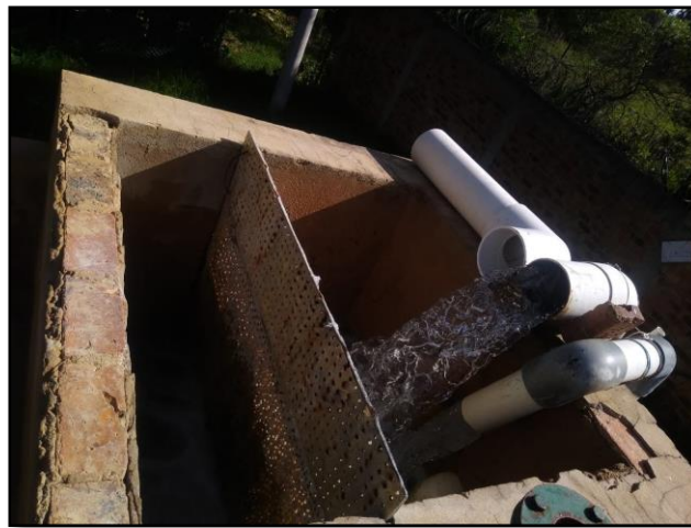
Fotografía 1. Tubería entrada de la PTAP.
