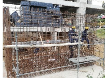
Figura 36. Acero de tanque de compensación
