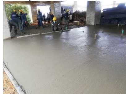
Figura 25. Placa de contrapiso
