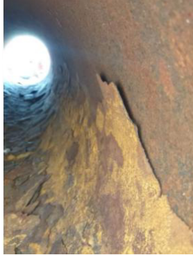
Fig. 11 Registro de estado interno de chimenea.
