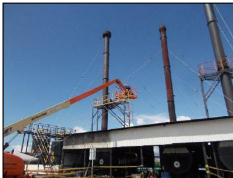
Fig. 10 Panorámica de la caldera 500 BHP
