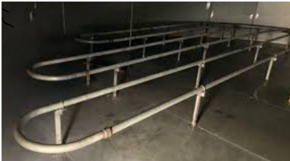
Figura 1. Interior de Tanques con serpentines.
