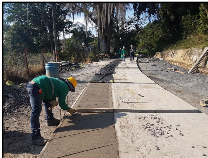
Figura 45. Textura de las placas de concreto clase D.
