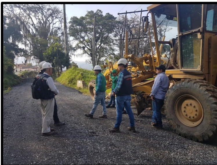
Figura 48. Inspección pre-operacional a los equipos.
