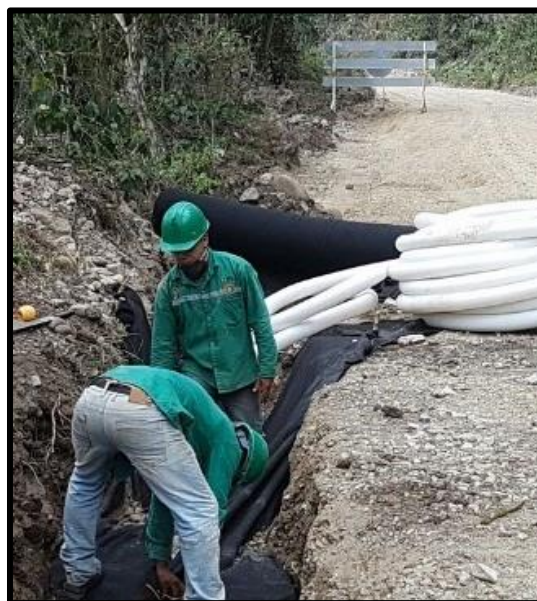
Nota: Fotografía de la instalación de la tubería drenante de 4” para la construcción del filtro en el k1+250. Fuente: Convenio 918 de 2014 UPTC – INVIAS.
