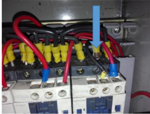
Figura 50. Contactor inversor de giro sistema eléctrico taladro fresador.
