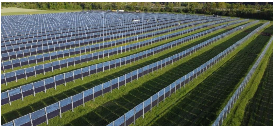
Abbildung 11: Anlagenbeispiel für Bewirtschaftungsstatus "Dauergrünland". Vertikale APV-Anlage von Next2Sun in Donaueschingen (Deutschland). Die bifazialen Module sind vertikal aufgeständert, Ausrichtung Ost-West, Reihenabstand 10 m (Next2Sun, 2020).
