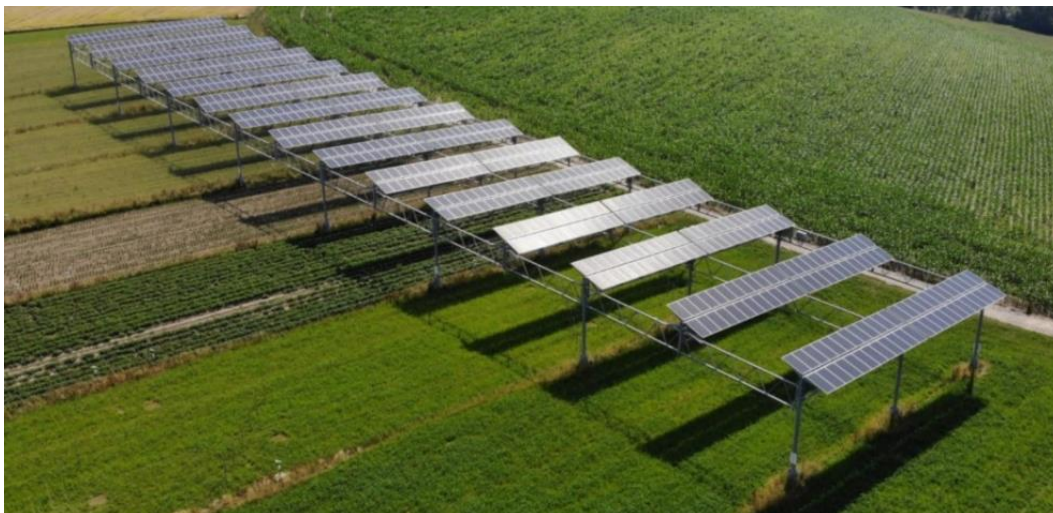
Abbildung 10: Anlagenbeispiel für Bewirtschaftungsstatus "Offene Ackerkultur". Agri-PV-Versuchsanlage (APV Resola) mit festinstallierten Modulen in Heggelbach (Deutschland). Die Module sind auf einer Höhe von 5.5 m installiert und der Stützenabstand in der Längsrichtung beträgt 19 m (Hofgemeinschaft Heggelbach, o. J.).
