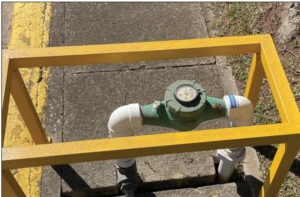
Figura 23 - Imagem do hidrômetro FQ06 – ADM
