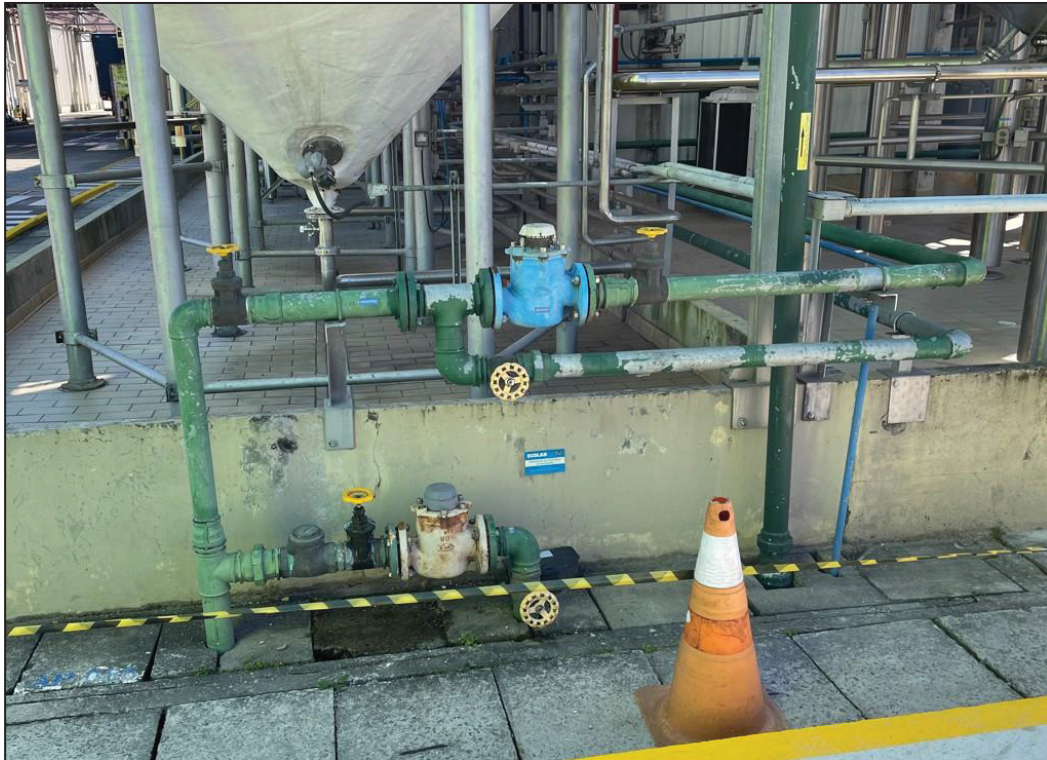
Figura 21 - Imagem dos hidrômetros FI
