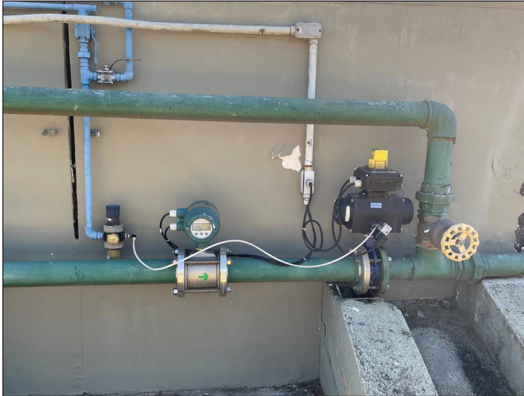
Figura 22 - Imagem do Flowmeter FT01 – ADM
