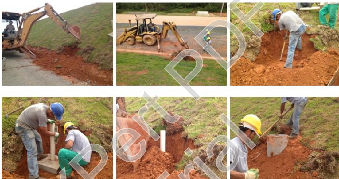
FIGURA 13 - SEQUENCIA DE INSTALAÇÃO DOS MARCOS SUPERFICIAIS DO ATERRO SANITÁRIO DE FAZENDA RIO GRANDE
