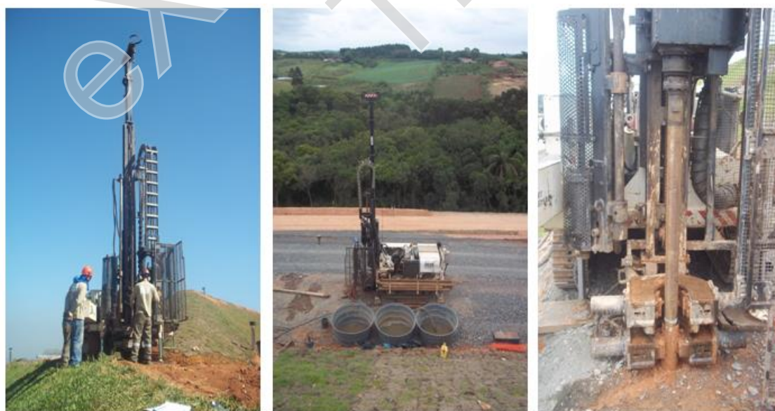
FIGURA 15 - IMAGENS DA INSTALAÇÃO DOS PIEZÔMETROS DO ATERRO SANITÁRIO DE FAZENDA RIO GRANDE
