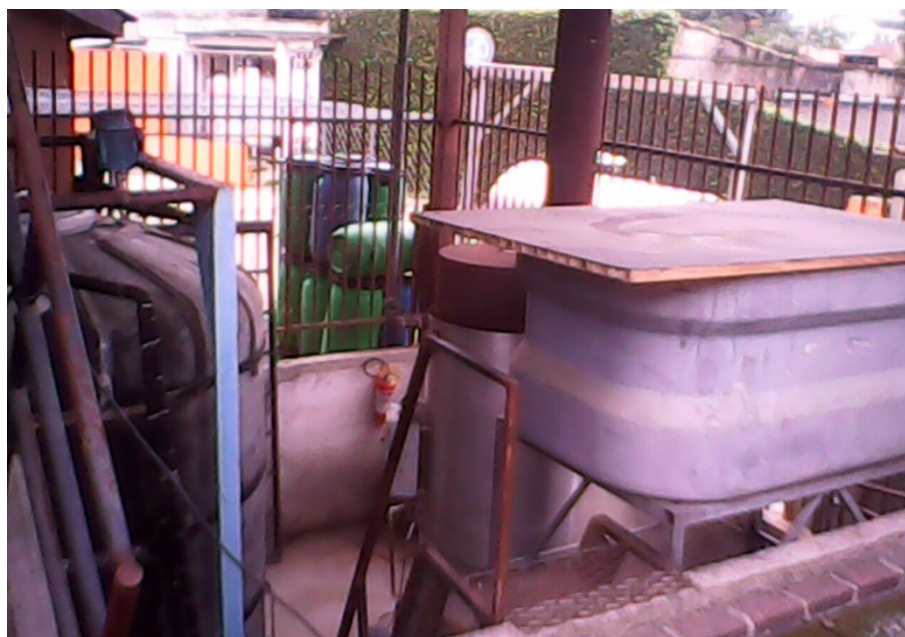
Figura 4.29 – Apoio hidráulico: À esquerda, tanque-refrigerador; no meio, caldeira; e à direita, caixa d'água da bomba do poço artesiano (Fonte: ACERVO DA AUTORA, 2013).
