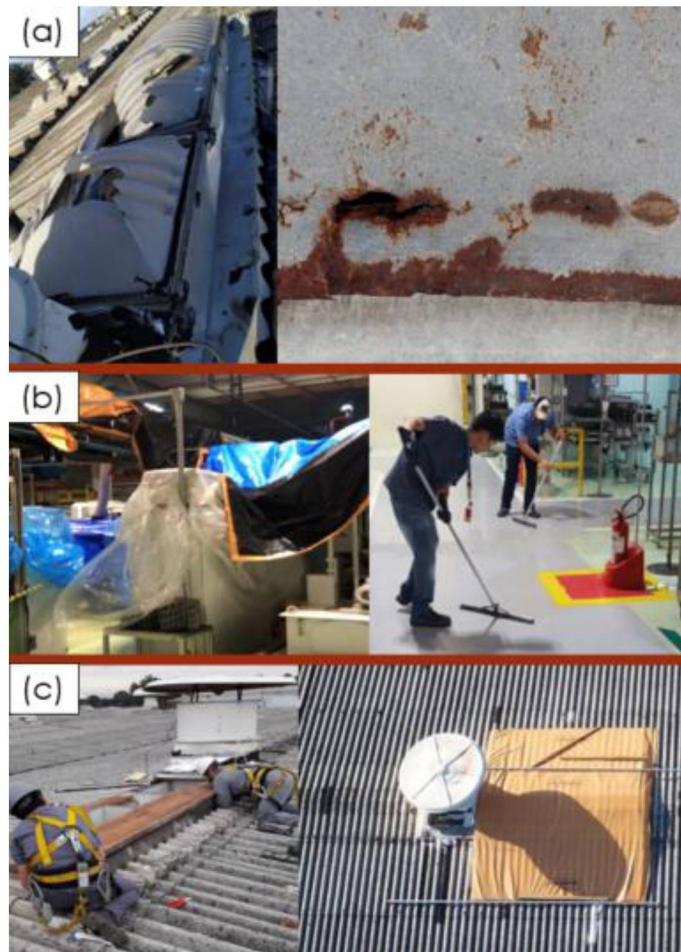
Figura 1: (a) Componentes dos telhados que apresentam oxidações como falhas em suas estruturas. (b) Ações necessárias para a contenção de infiltrações nas áreas fabris. (c) Ações corretivas necessárias nas estruturas danificadas. Fonte: o autor (2023).
