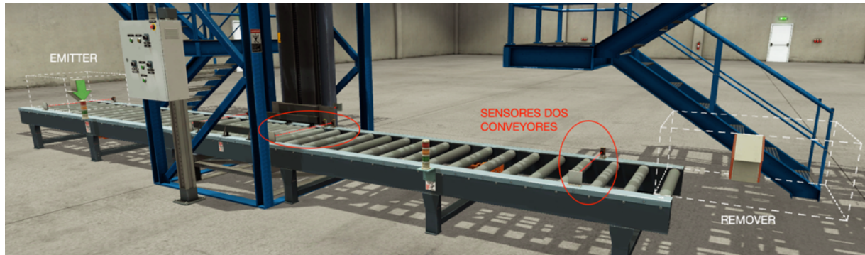
Figura 35 - Pormenor dos sensores dos conveyors , emitters e removers
